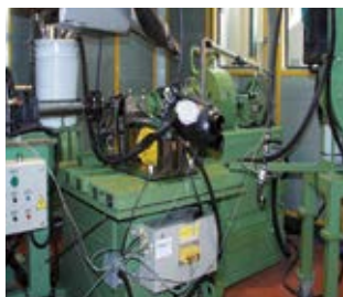
EQUIPOS Y BANCOS DE TEST
